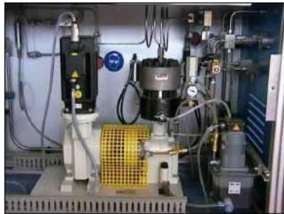
Unidad inyección de nitrógeno
