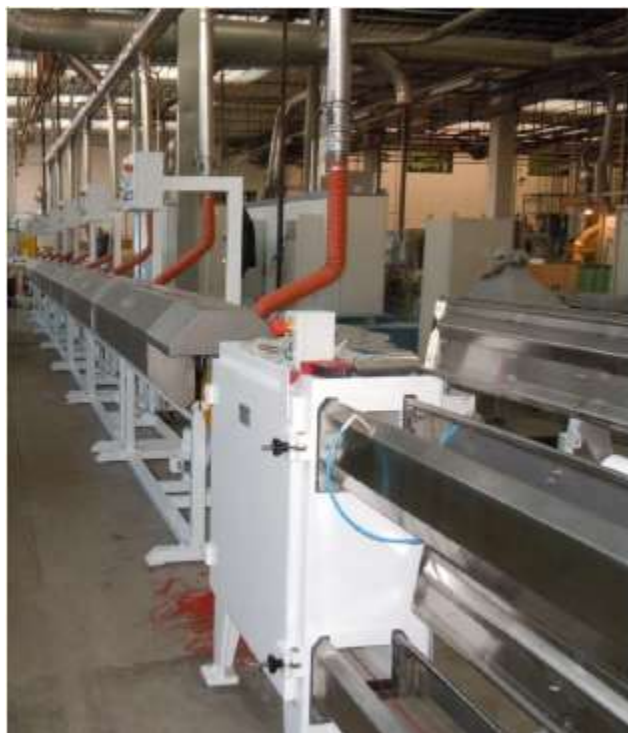
Tunnel a raggi infrarossi
