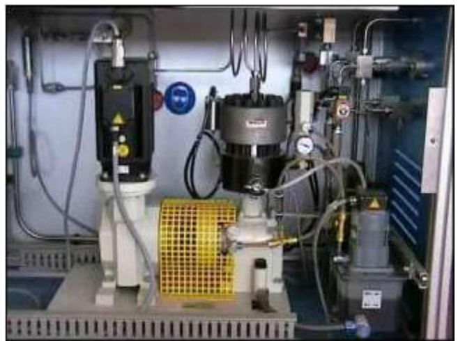
Unidad de inyección de nitrógeno
